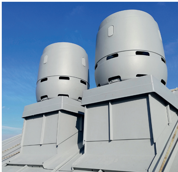
Hopeanharmaat VILPE 315/400S FLOW -ulospuhallushajottimet asennettuina kaltevalla katolla. Kuvan läpiviennit ovat asiakkaan rakentamat.
